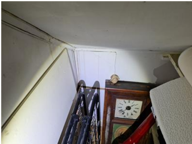
Lägenhet 1/Förråd: Rinnmärken förekommer i tak/väggvinkel.
