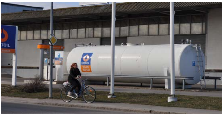
Station för truckdiesel vid Vintergatan.
