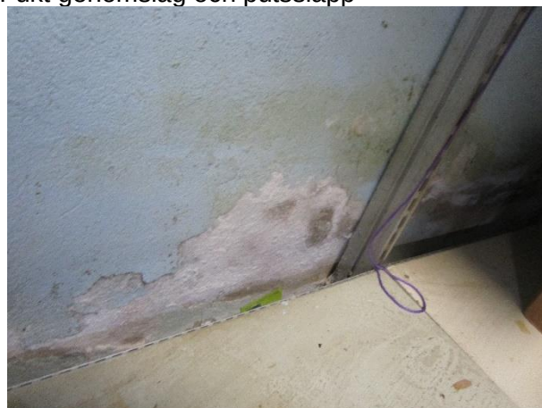
Fuktgenomslag längs yttervägg i förråd
