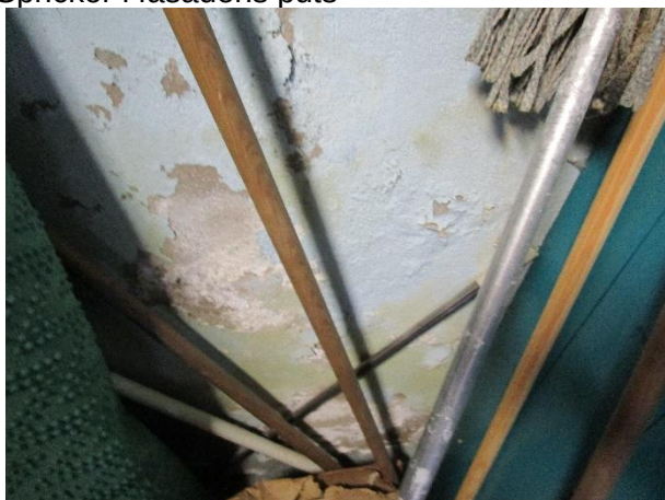
Fuktgenomslag längs ytterväggar i tvättstugan
