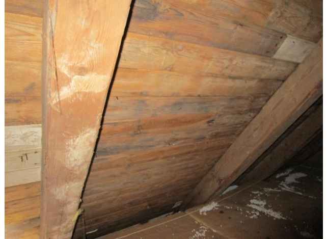
Missfärgningar längs brädor på vinden
