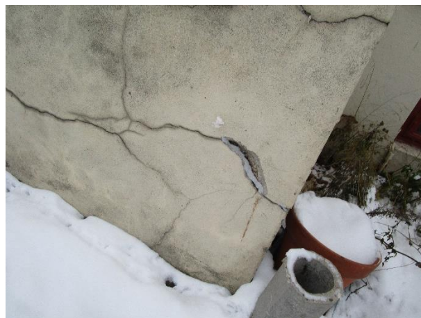
Sprickor längs entrétrappan
