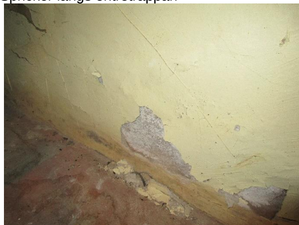
Fukt genomslag och putssläpp
