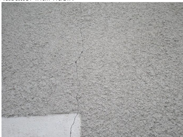
Sprickor i fasadens puts
